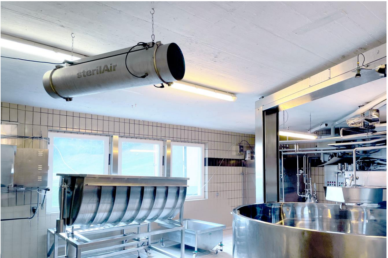
Der UVR-4K „schwebt“ über der Produktion und sorgt für optimale Luftverhältnisse.
